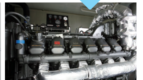
非常用発電機
