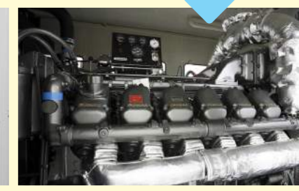
非常用発電機
